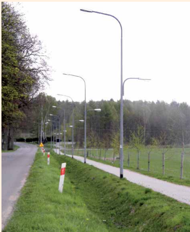
Oświetlenie przy ul. Puckiej w Choczewie – 2006
