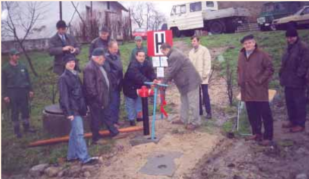
Wodociąg w Choczewku – 2004
