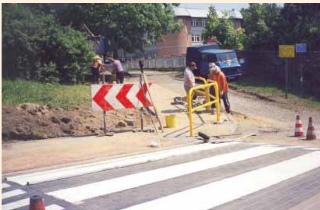
Budowa spowalniaczy na ul. Kusocińskiego w Choczewie w ramach zadania: Uspokojenie i organizacja ruchu w otoczeniu szkół na drogach powiatowych – 2003
